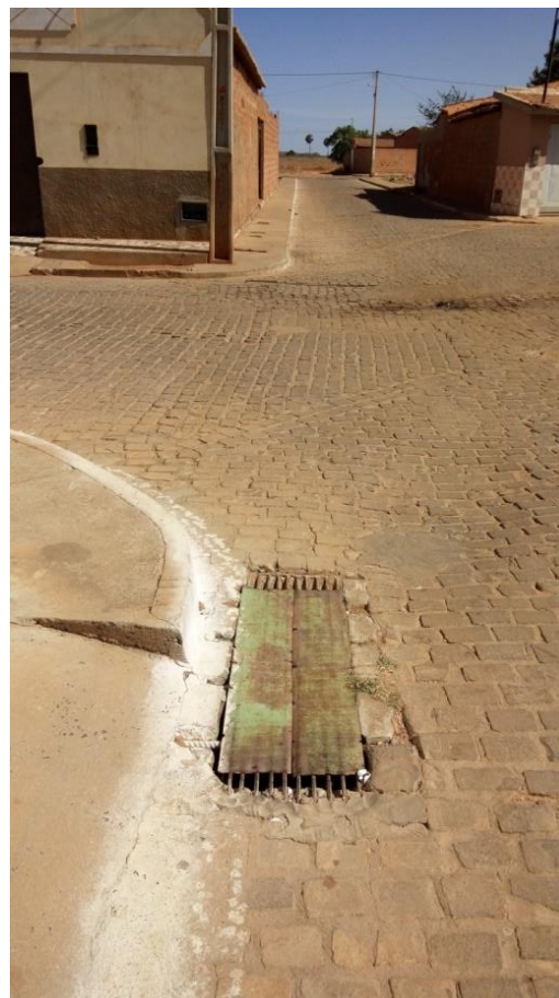
Figura 4-158 - Boca de lobo com chapa de metal próximo à Prefeitura Municipal
