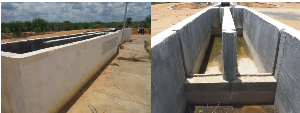
Figura 4-67 – Caixa de areia e calha parshall do SES, na sede de Itaguaçu da Bahia.
