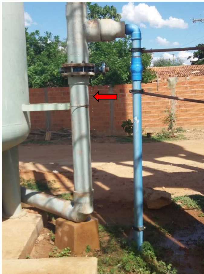
Figura 4-37 – Detalhe do ponto de vazamento no filtro
