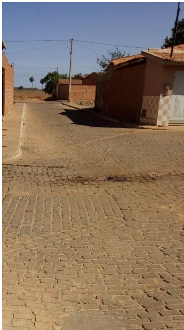
Figura 4-142 - Área sem dispositivos de microdrenagem, próximo a Prefeitura Municipal Fonte: Projeta Engenharia (2017)
