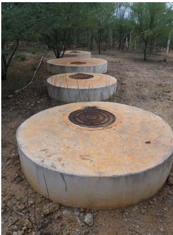
Figura 4-64 – Reservatórios para armazenamento de efluente da EBE-1, na sede de Itaguaçu da Bahia.
