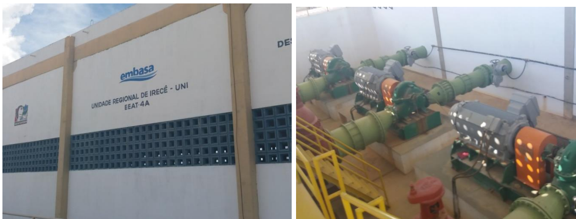
Figura 4-25 – Estação Elevatória de Água Tratada 4A e conjuntos moto-bomba Fonte: Projeta Engenharia (2017)
