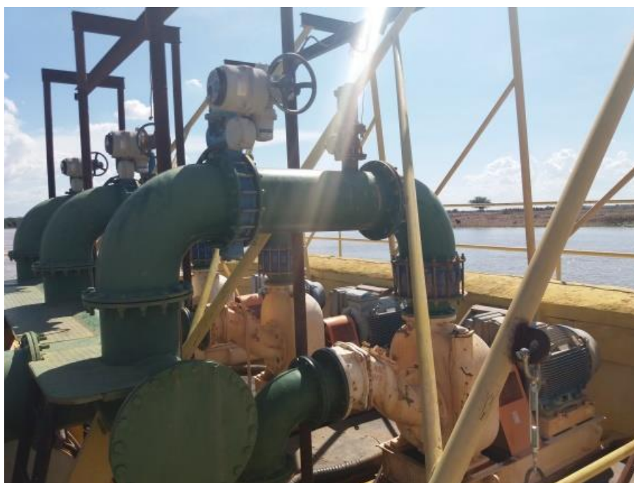
Figura 4-9 – Conjuntos moto-bomba da captação na balsa.
