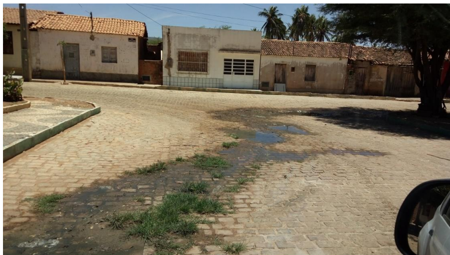
Figura 4-57 – Vazamento de esgoto na Rua Clovis Peregrino, na sede de Itaguaçu da Bahia.
