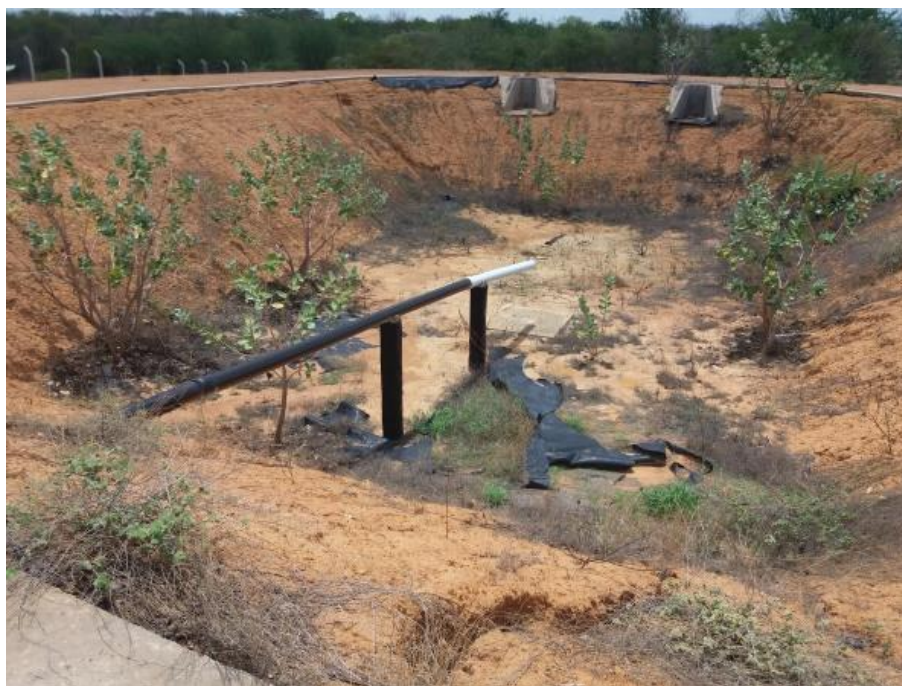
Figura 4-68 – Lagoa anaeróbia do SES, na sede de Itaguaçu da Bahia.
