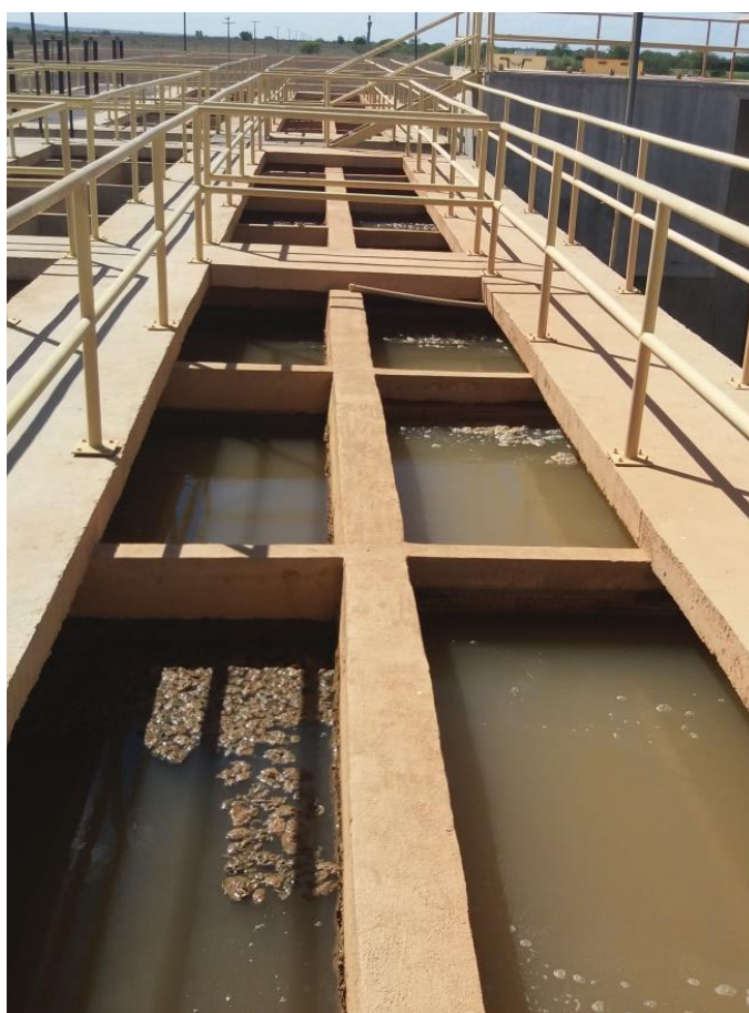
Figura 4-13 – Câmaras de floculação na ETA Rio Verde
