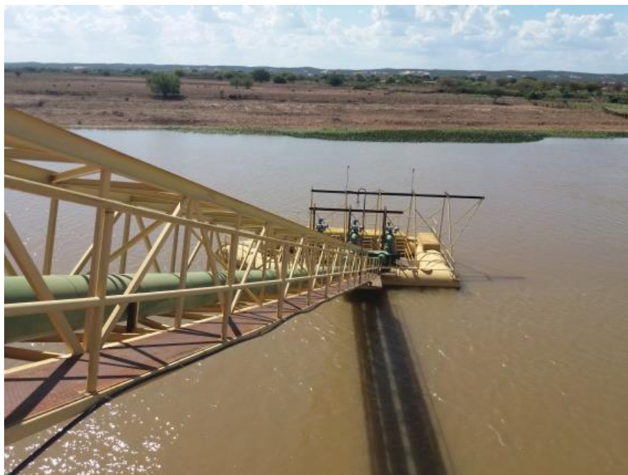
Figura 4-8 – Balsa flutuante da captação no Rio São Francisco.
