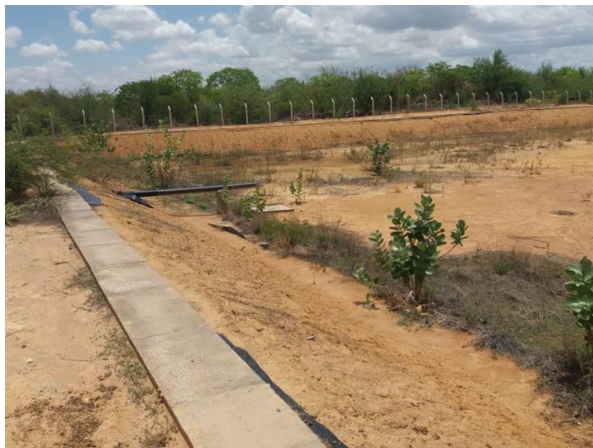
Figura 4-71 – Lagoa facultativa do SES, na sede de Itaguaçu da Bahia.
