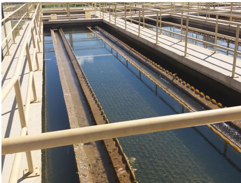
Figura 4-14 – Decantador na ETA Rio Verde
