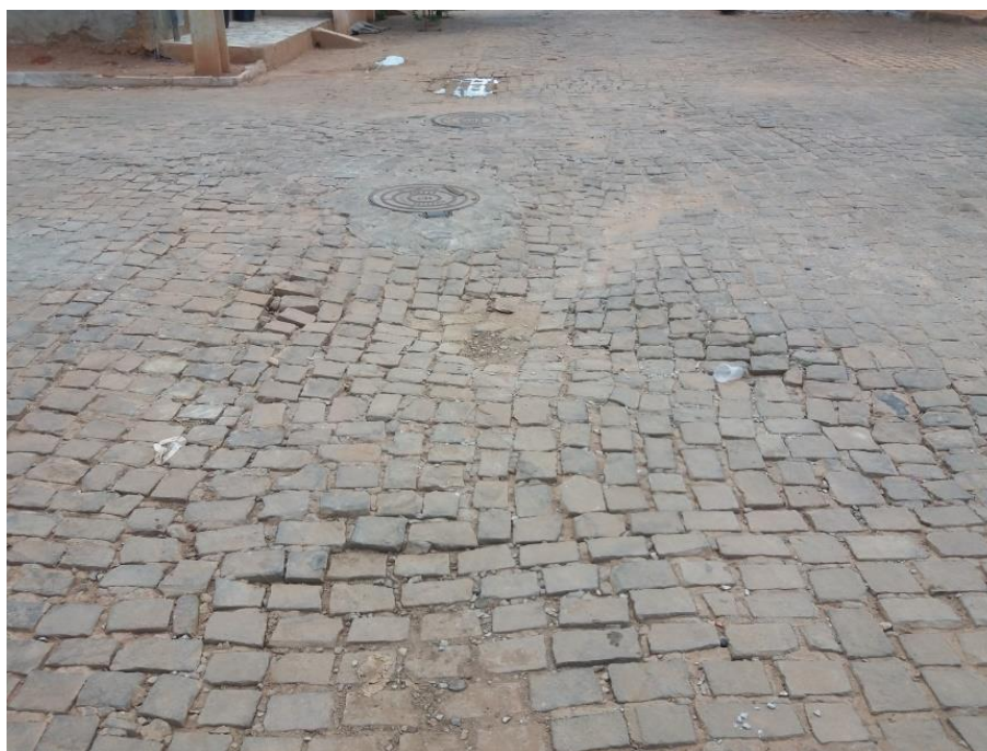
Figura 4-56 – Local da Rua Clovis Peregrino onde ocorreu o rompimento da rede coletora na sede de Itaguaçu da Bahia.
