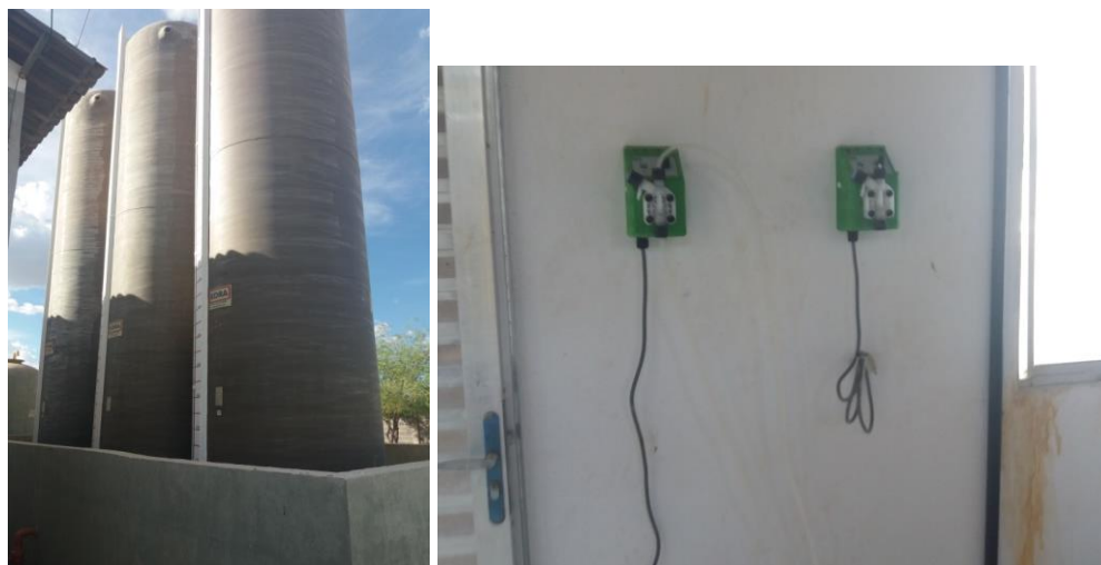
Figura 4-23 – Tinas de sulfato e dosadores de flúor da Casa de Química da ETA Rio Verde
