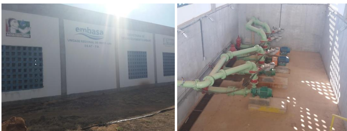
Figura 4-26 – Estação Elevatória de Água Tratada 9A e conjuntos moto-bomba Fonte: Projeta Engenharia (2017)
