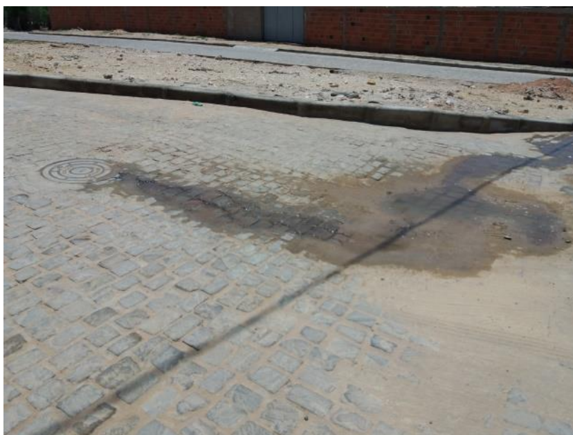
Figura 4-62 – Vazamento do poço de visita na Rua José Búzio de Carvalho, na sede de Itaguaçu da Bahia.
