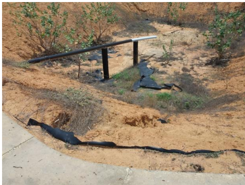
Figura 4-69 – Estado de degradação da lagoa anaeróbia do SES, na sede de Itaguaçu da Bahia.
