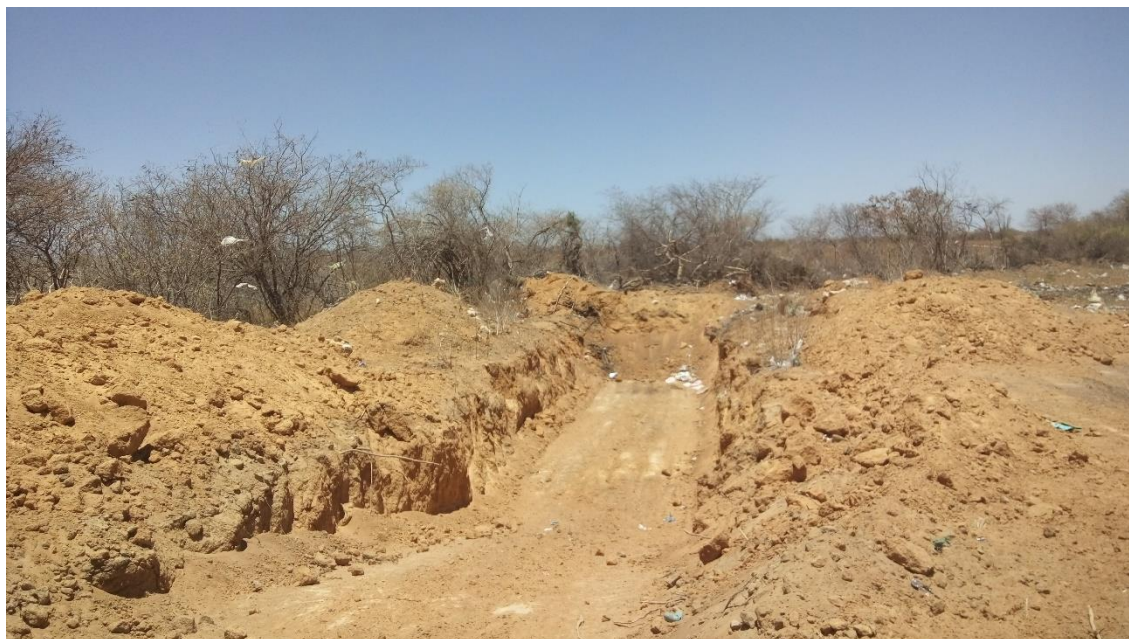
Figura 4-131 – Abertura de nova vala para recobrimento de resíduos no lixão municipal de Itaguaçu da Bahia
