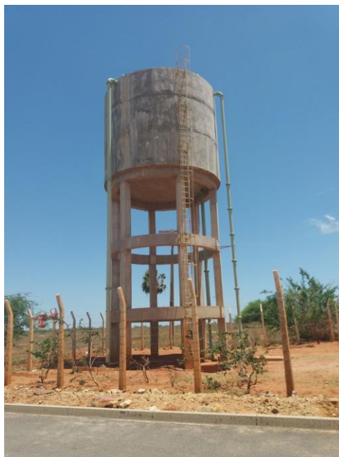
Figura 4-27 – Reservatório da sede de Itaguaçu da Bahia Fonte: Projeta Engenharia (2017)
