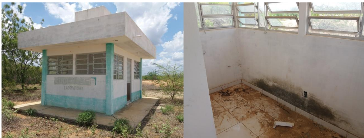
Figura 4-66 – Estrutura do Laboratório do SES, na sede de Itaguaçu da Bahia.
