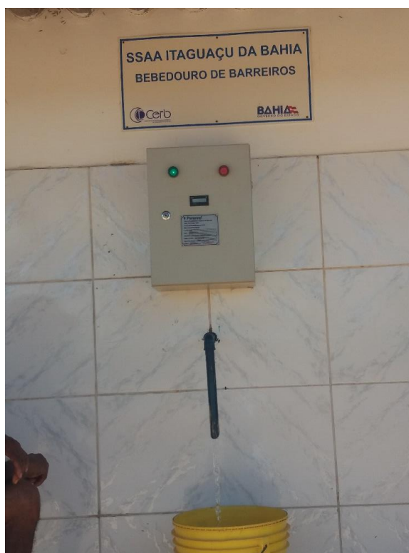
Figura 4-39 – Equipamento do sistema de fichas para pegar água em Bebedouro de Barreiros.
