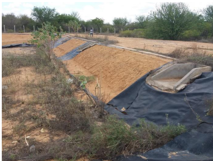
Figura 4-72 – Degradação da lagoa facultativa do SES, na sede de Itaguaçu da Bahia.
