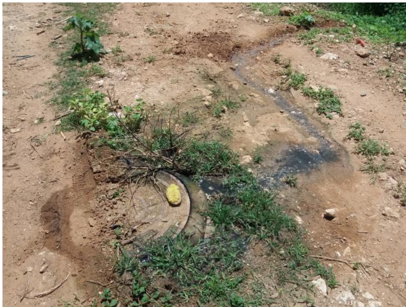
Figura 4-61 – Vazamento do poço de visita em rua próxima ao córrego Olho d'Água, na sede de Itaguaçu da Bahia.
