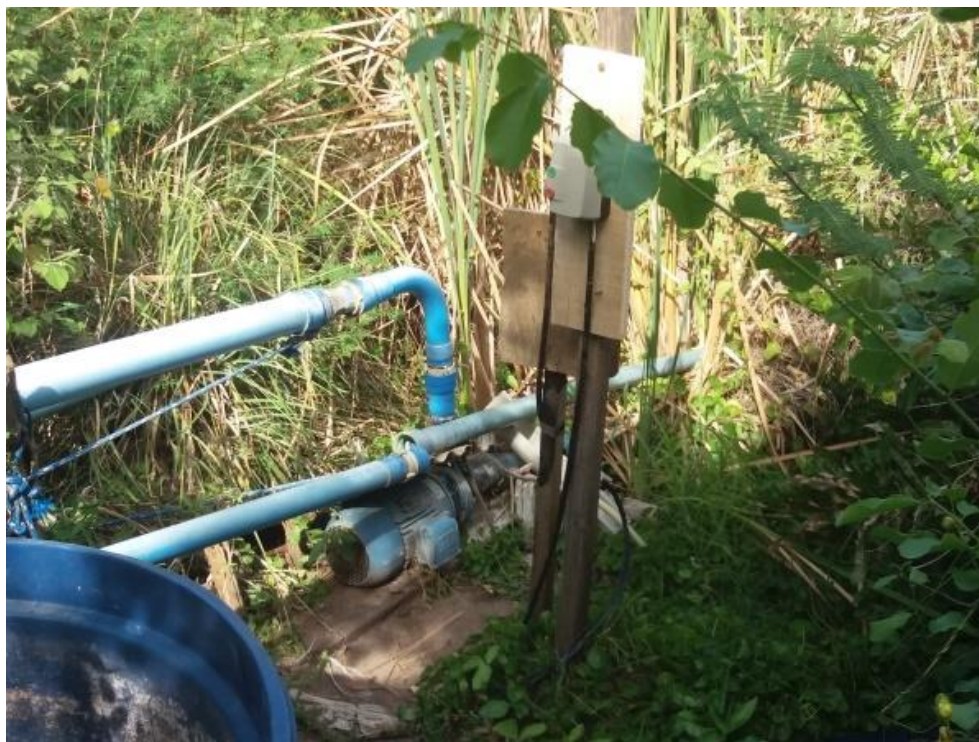
Figura 4-34 – Ponto de captação no Rio Verde
