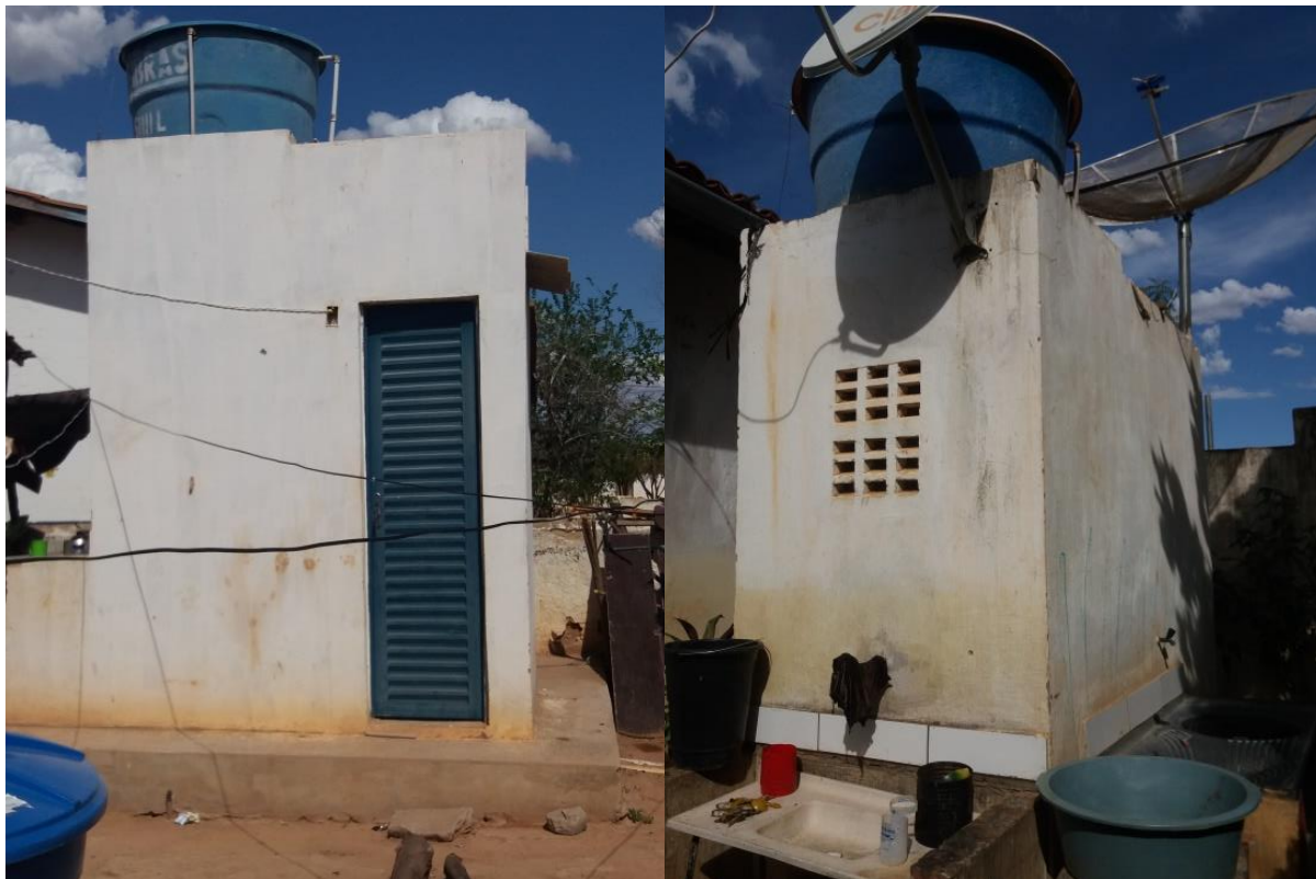
Figura 4-78 – Banheiro instalado pela Funasa, em Barreiros. Fonte: Projeta Engenharia (2017)
