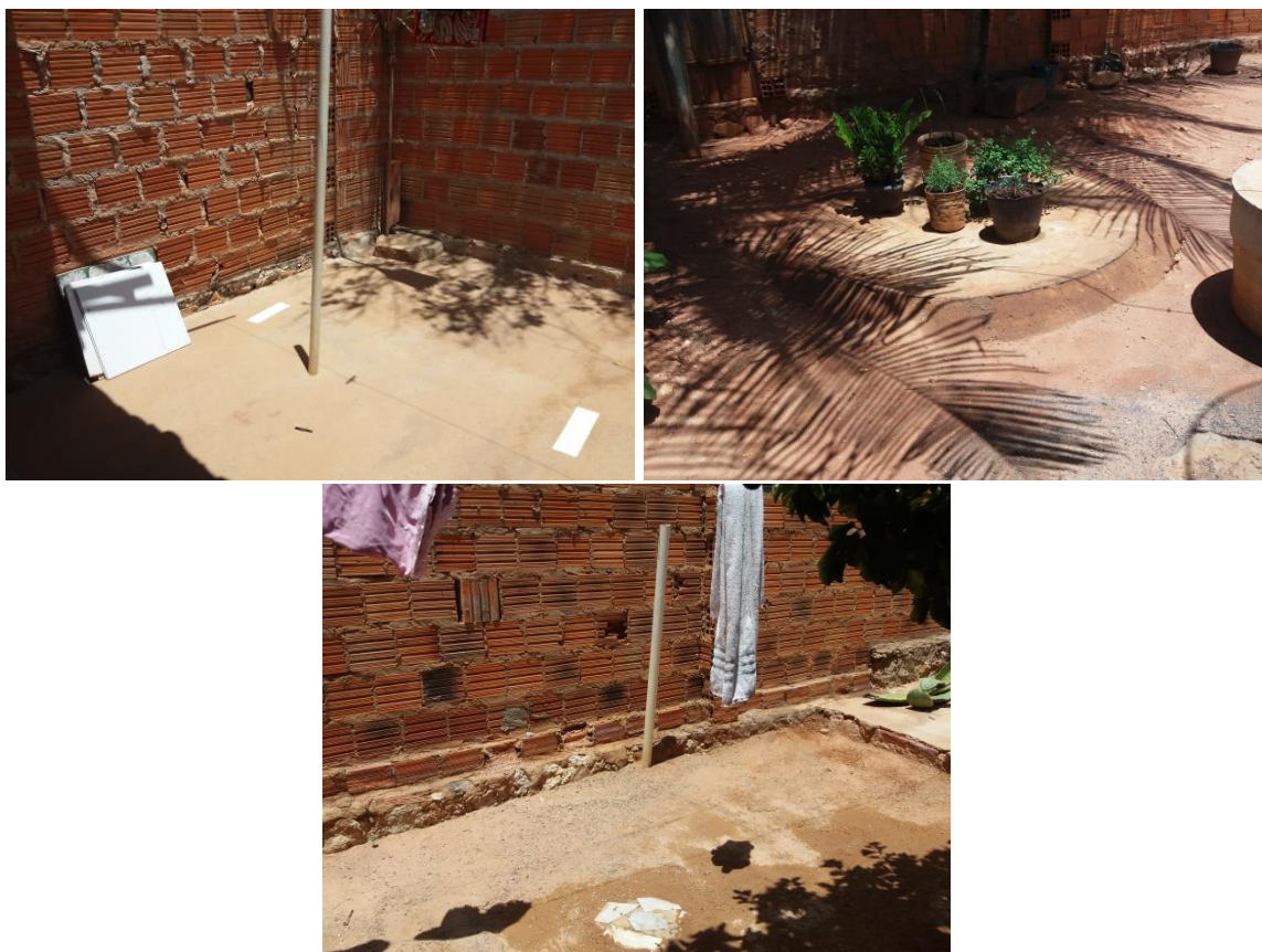
Figura 4-55 – Fossas rudimentares nos domicílios da sede de Itaguaçu da Bahia.
