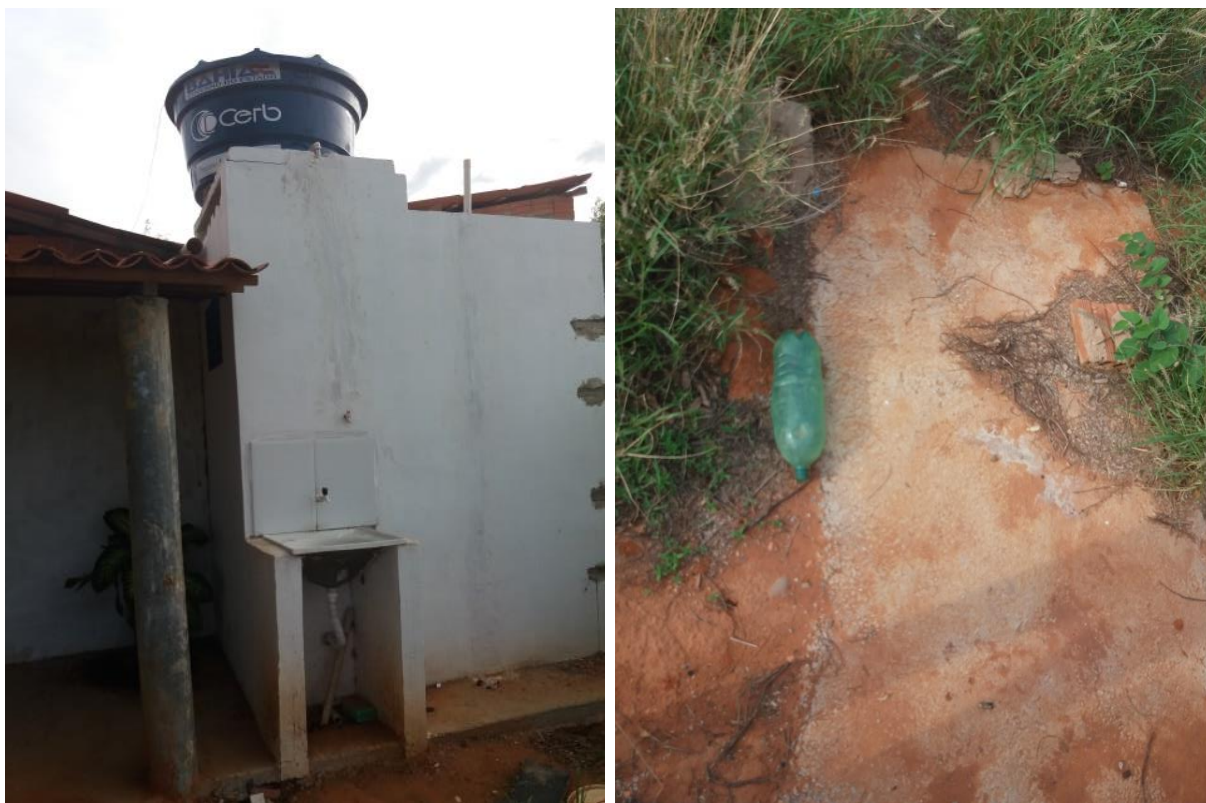
Figura 4-80 – Banheiro e espaço para a fossa rudimentar e sumidouro instalados pela CERB, em Estrada do Poço.
