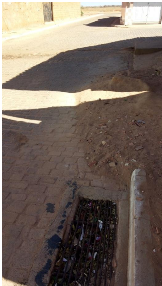
Figura 4-157 - Entupimento de boca de lobo próximo à Prefeitura
