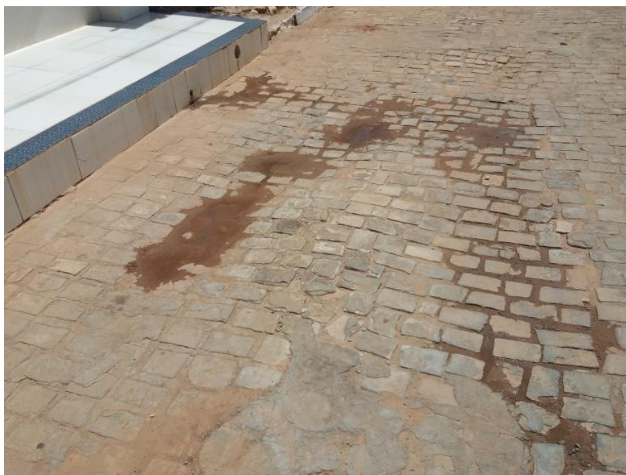
Figura 4-58 – Vazamento de água cinza na Rua Clovis Peregrino, na sede de Itaguaçu da Bahia.
