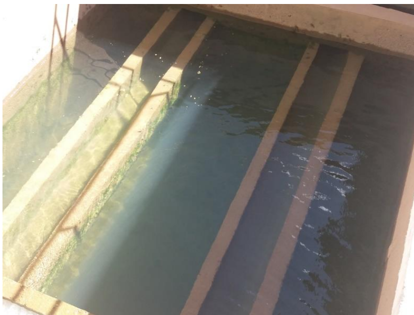
Figura 4-15 – Filtro na ETA Rio Verde
