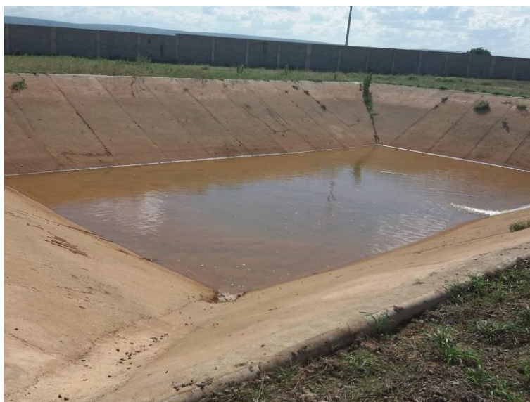
Figura 4-19 – Lagoa de equalização da água de lavagem dos filtros da ETA Rio Verde
