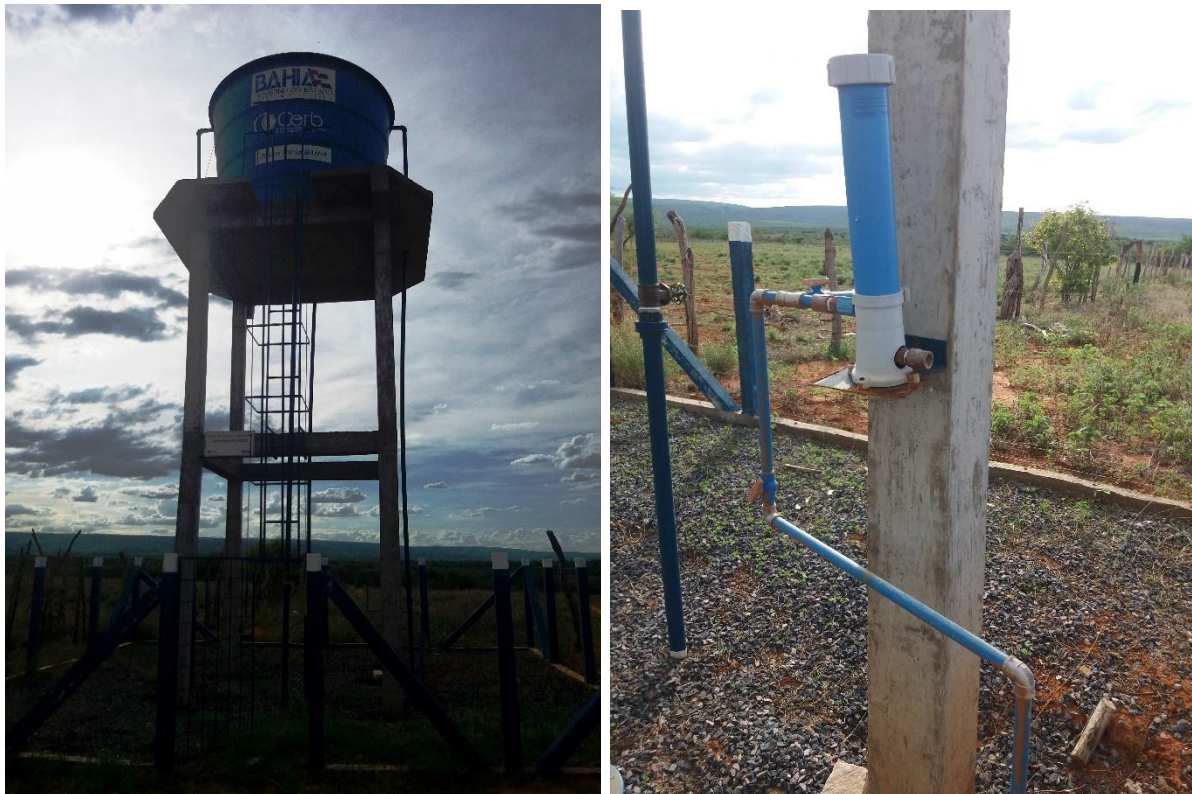
Figura 4-40 – Sistema Simplificado com cloro em pastilha em Estrada do Poço.
