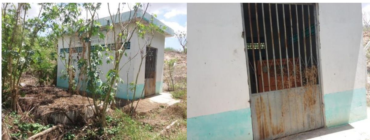
Figura 4-65 – Estação Elevatória EBE-2, na sede de Itaguaçu da Bahia.
