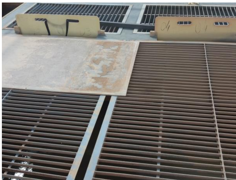
Figura 4-12 – Caixas de distribuição para coagulação na ETA Rio Verde Fonte: Projeta Engenharia (2017)
