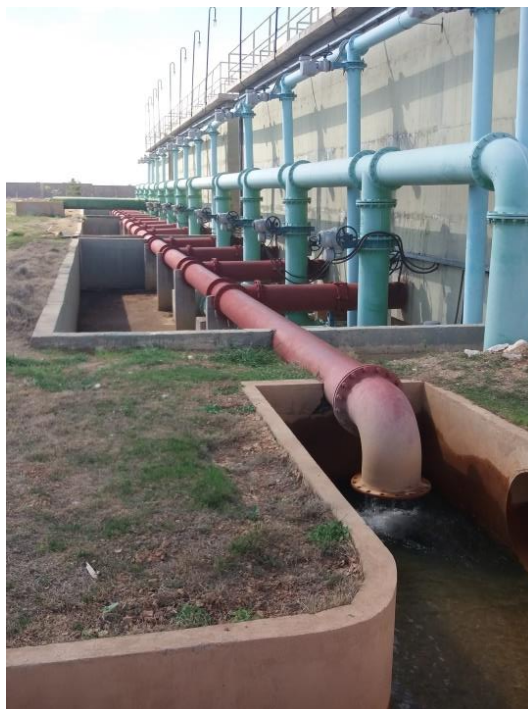
Figura 4-18 – Tubulação de recirculação da água dos filtros da ETA Rio Verde Fonte: Projeta Engenharia (2017)
