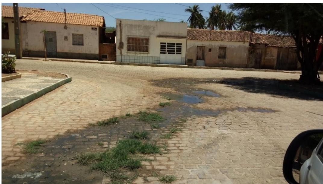
Figura 4-148 - Escoamento superficial de esgoto na Sede do Município
