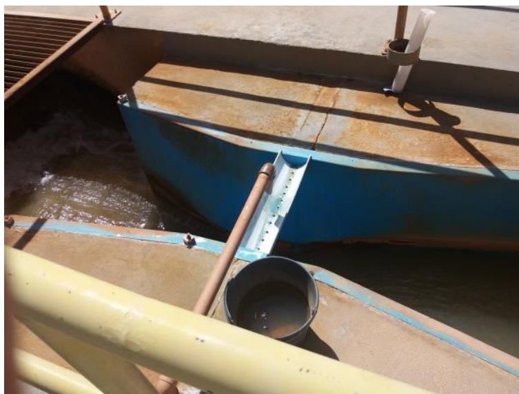
Figura 4-11 – Dosador de coagulante na calha parshall na ETA Rio Verde Fonte: Projeta Engenharia (2017)
