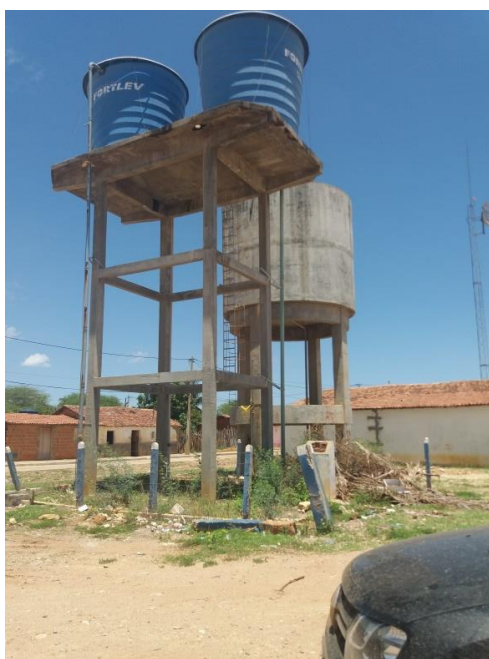
Figura 4-28 – Reservatórios (de fibra) da localidade de Rio Verde I Fonte: Projeta Engenharia (2017)
